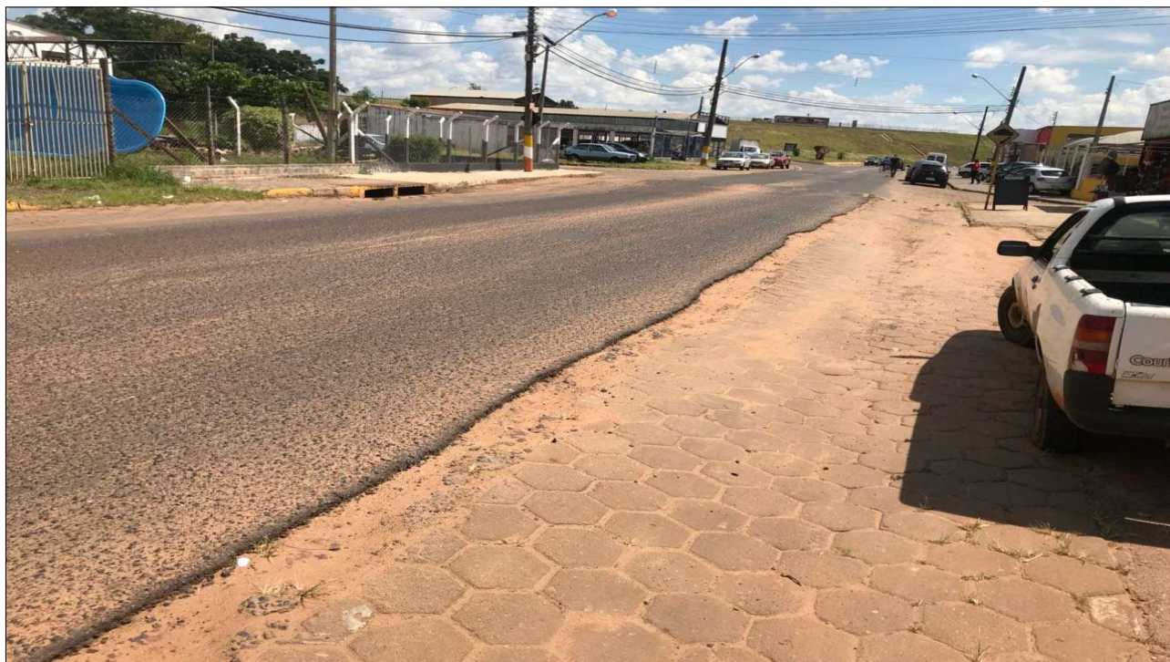
Foto 2. Situação atual da via na Av. Anápolis.
