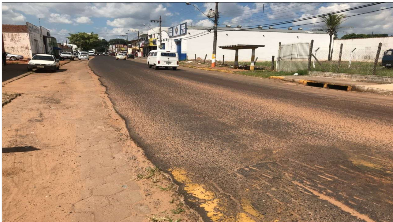
Foto 3. Situação atual da via na Av. Anápolis.
