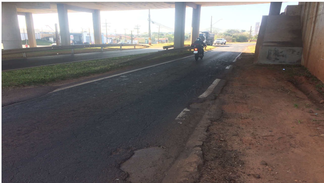
Foto 12. Situação atual da via na Av. Anápolis.
