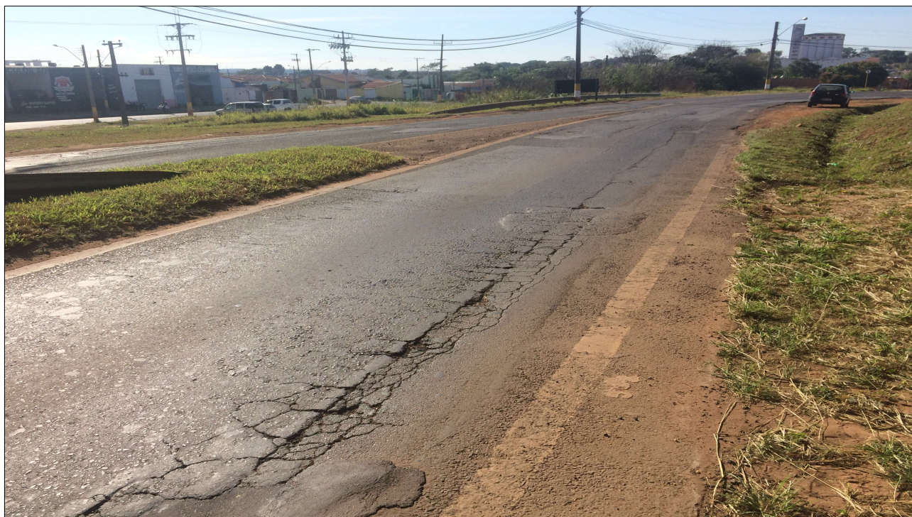
Foto 11. Situação atual da via na Av. Anápolis.
