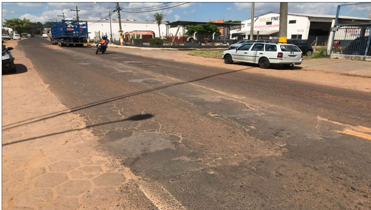
Foto 5. Situação atual da via na Av. Anápolis.
